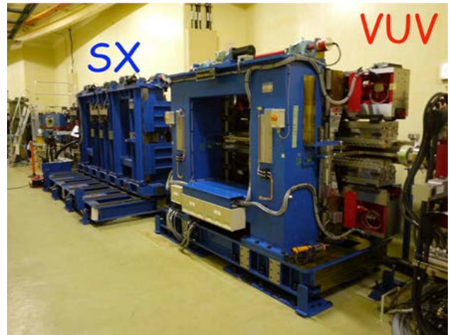
図2 BL-2長直線部に設置された真空紫外(VUV)用および軟X線(SX)用アンジュレータ。
